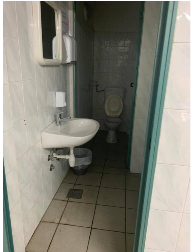
Slika 61. Neprilagođen WC za osobe s invaliditetom u košarkaškoj dvorani Brajda
