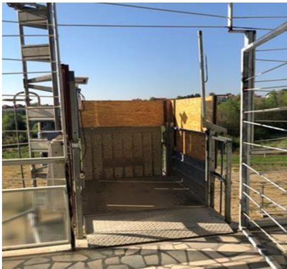
Slika 3. Vanjsko dizalo na balkonu u zgradi Švarča 1
