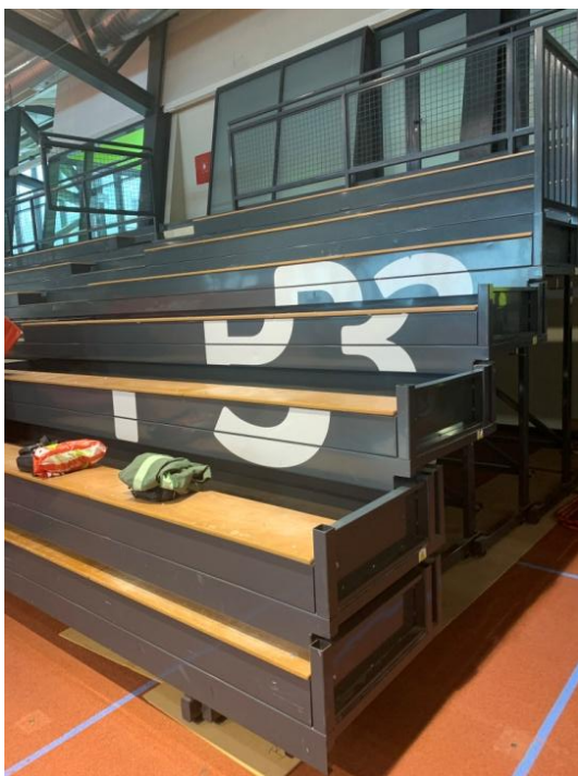
Slika 3. Teleskopsko gledalište u atletskoj dvorani Kantrida
