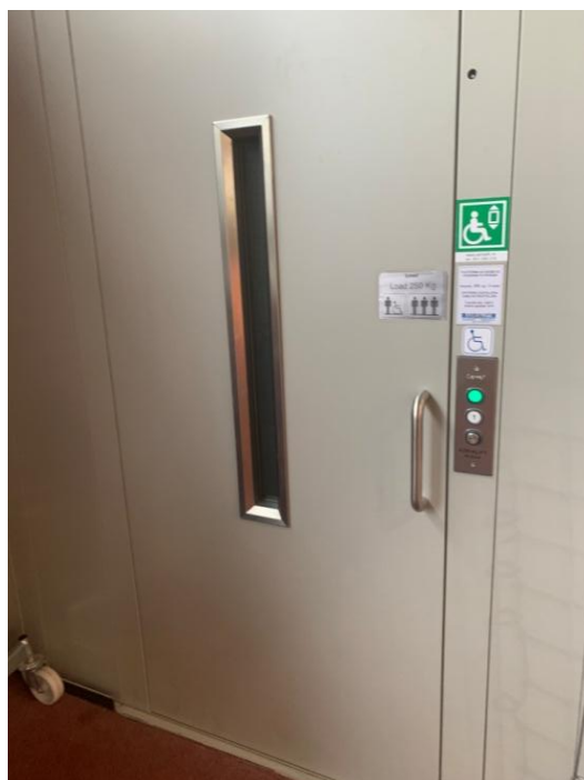
Slika 4. Dizalo u atletskoj dvorani Kantrida
