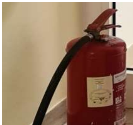
Slika 13. Aparat za gašenje požara u stacionaru Pazin
